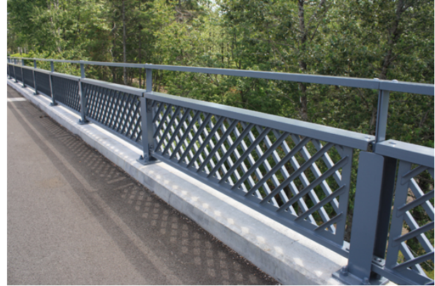
16. Un nouveau garde-corps, inspiré du modèle ancien et adapté aux normes actuelles, a été conçu tout spécialement pour le pont de Shannon.
